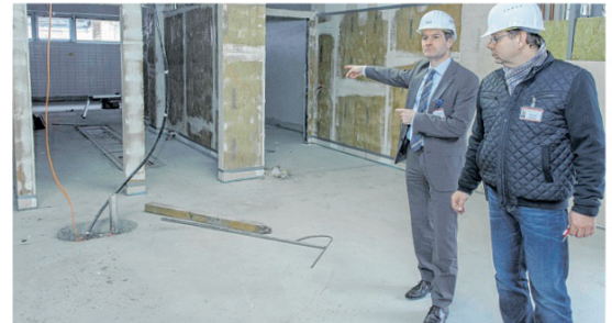
Im Untergeschoss des Anbaus West schreitet der Ausbau des Küchenbereichs voran. Eine Bandspülmaschine wird dort ihren Raum finden.
