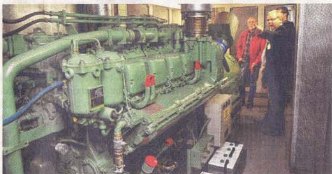
Wenn ein Trafo ausfällt, springt das Dieselaggregat im „alten Kesselhaus“ an und versorgt die wichtigsten Gebäudeteile mit Strom.
